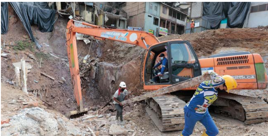
Maquinaria y personal gubernamental realiza trabajos en el socavón en el cantón Zaruma, provincia El Oro, el 06 de enero de 2022.
